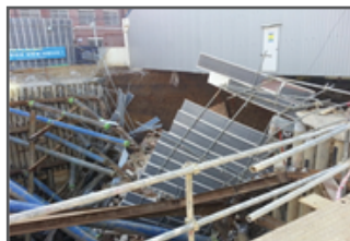
○○동 지하훅막이(2016) 배면에 작업창고 설치로 훅막이 구조물 과다 하중작용
