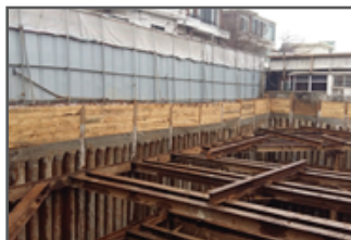
○○동 지하훅막이(2015) 지중경사계 계측 오류(작업통로 미확보)로 초기 과다 굴착 미확인
