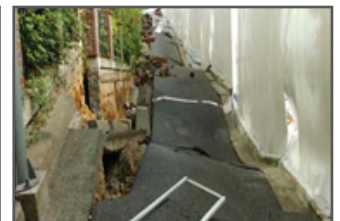
○○동 지하훅막이(2018) 배면지반 내 지하수위 상승에 따른 훅막이 구조물 작용 수압 증가
