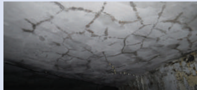
그림 3. 균열 손상 예(oo교량)
