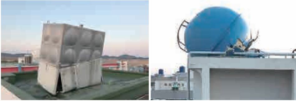
[그림 3] 포항지진에 의한 수조 파해사진
