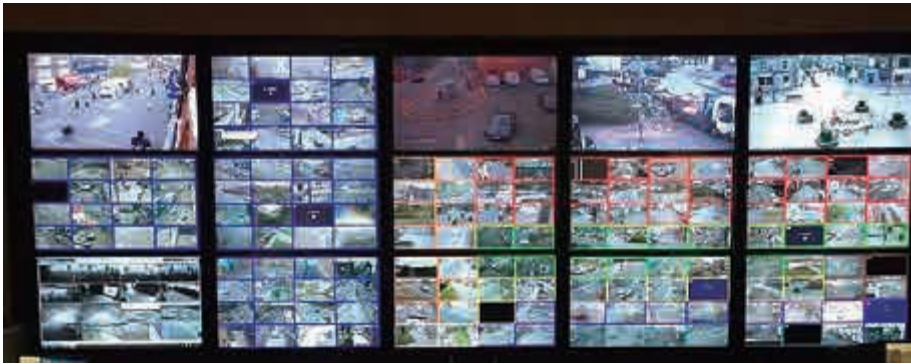
[그림4] 관제센터 CCTV 모니터링 화면
